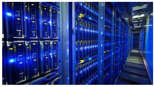
centro de cómputos
