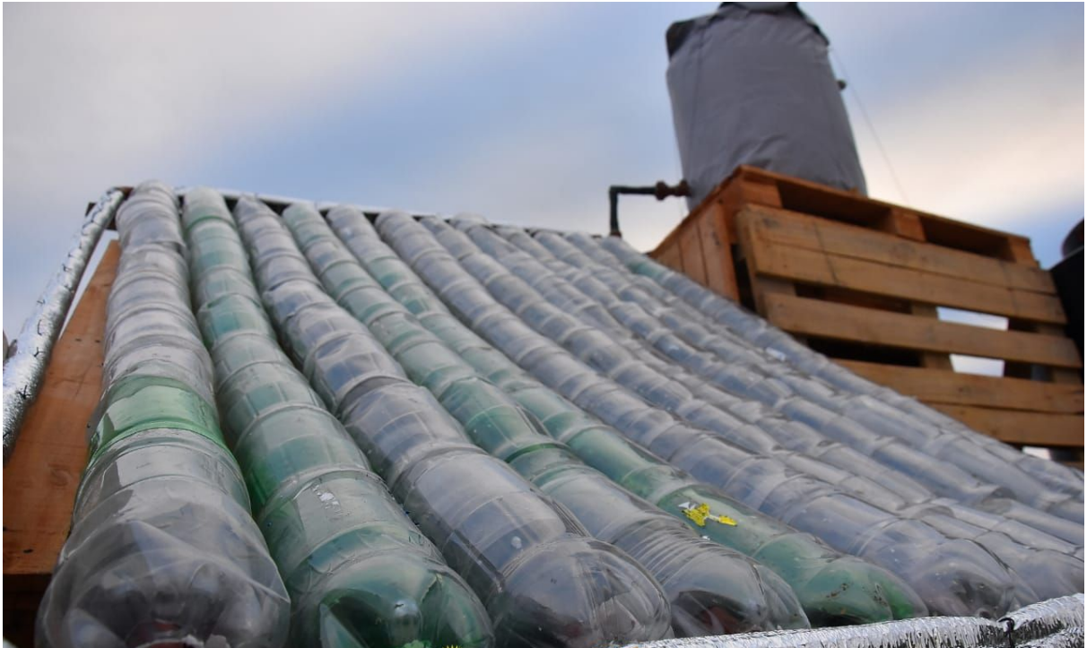
Termotanque solar construido en la ciudad de Cosquín el día 29 de septiembre de 2018.
